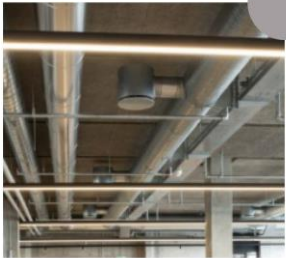
Kontorslandskap, mötesrum Ljudabsorbent, Industry Modus (NCS 3502-Y). 150mm under uk bjälklag. Synliga installationer nedan.
