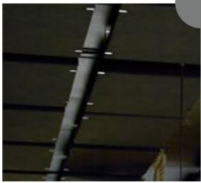
Korridorsstråk AKUTSTIKMILJÖ – Bygelabsorbent lätt (svart) Nedpendlat undertak med synligt bärverk. Lackad i kulör lika undertaksplatta.
